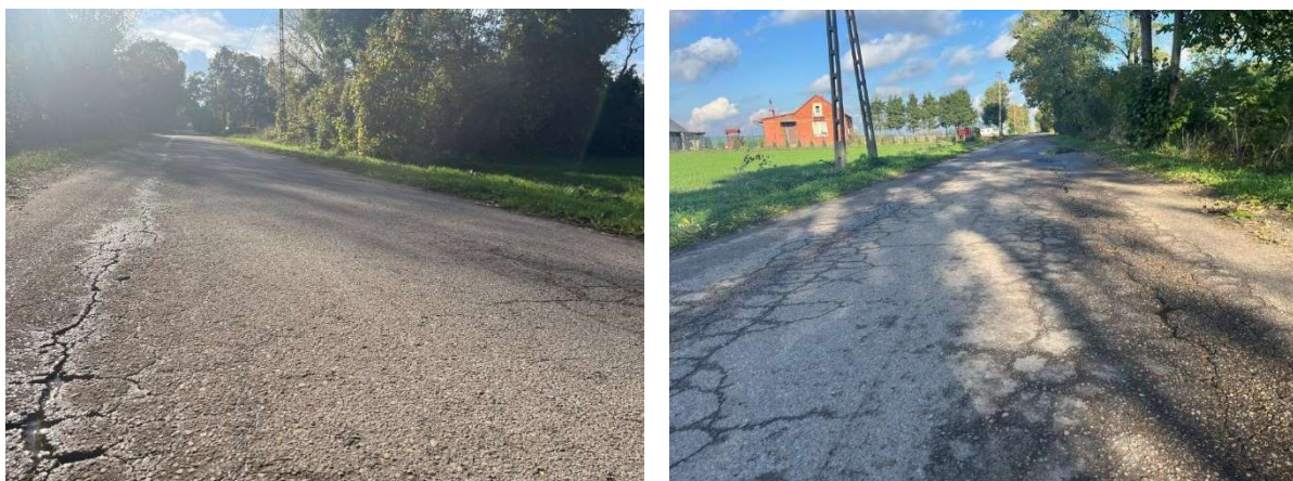
Rysunek 1. Stan techniczny drogi przebiegającej przez Sosenkowo
